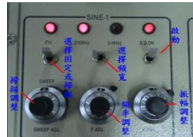
圖2 控制面板實際照片
